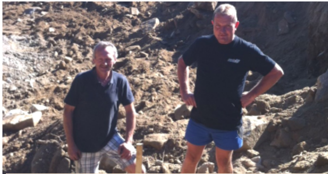
Baubeginn beim Wasserhaus in Kerschbaum, welches schlussendlich auch Hörschlag und Teile von Rainbach versorgen wird. Am Bild: Grundbesitzer Johann Hager im Gespräch mit dem Baggerfahrer der Firma WDS.
